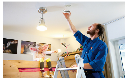
Der Fachmann prüft die wohnlichen Gegebenheiten und kümmert sich um die professionelle, sichere Installation der Haustechnik. (Foto: Hager Vertriebsgesellschaft)
