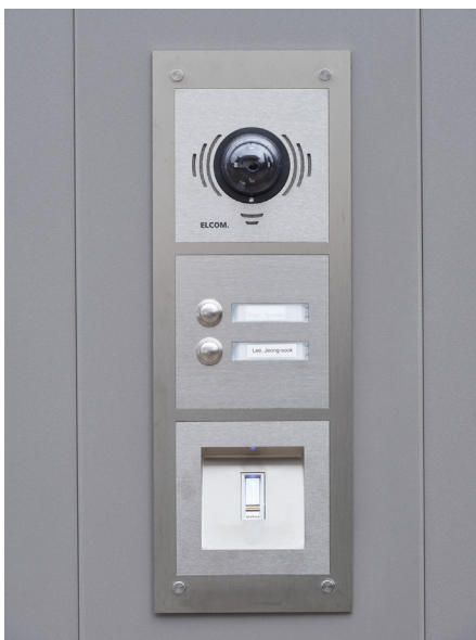
Dank des innovativen Türsystems von Elcom inklusive Audio/Video-Sprechanlage wissen die Bewohner immer, wer zu Besuch kommt – das gibt ein sicheres Gefühl. (Foto: Hager Vertriebsgesellschaft)
